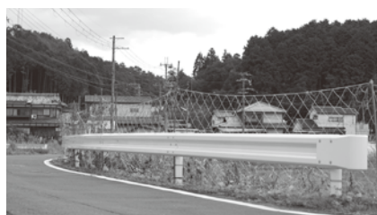
安全対策として設置されたガードレール
