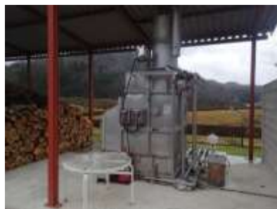
グリーンランドみずほの薪ボイラ
