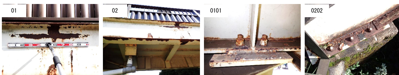
上部構造（主桁）：主桁 01・02（腐食）
