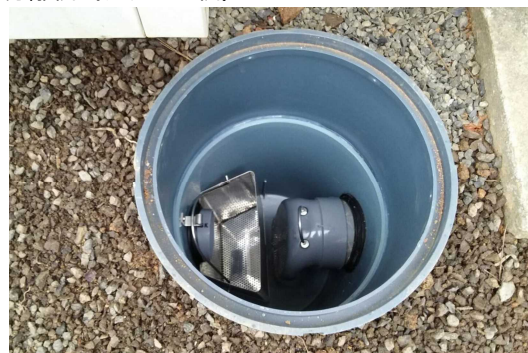
分離桝（クリーン桝）
