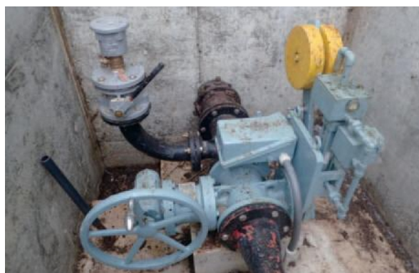
水原配水池(緊急遮断弁)
