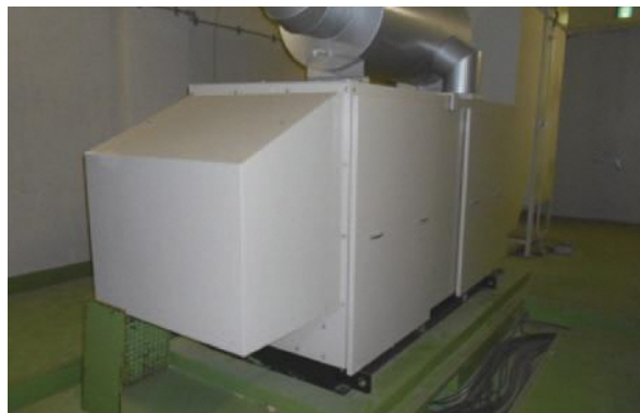
畑川浄水場(自家発電設備)
