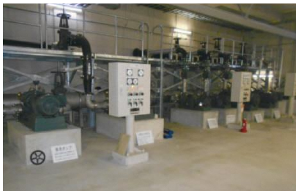
畑川浄水場(送水ポンプ室)
