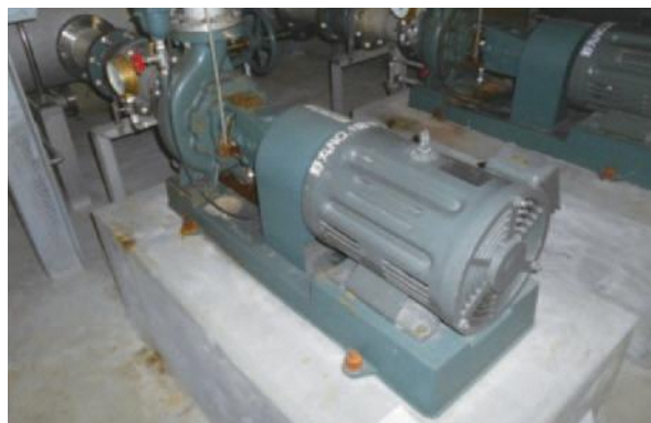
畑川浄水場(送水ポンプ)
