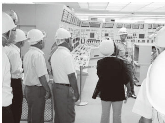
高浜原発中央制御室
