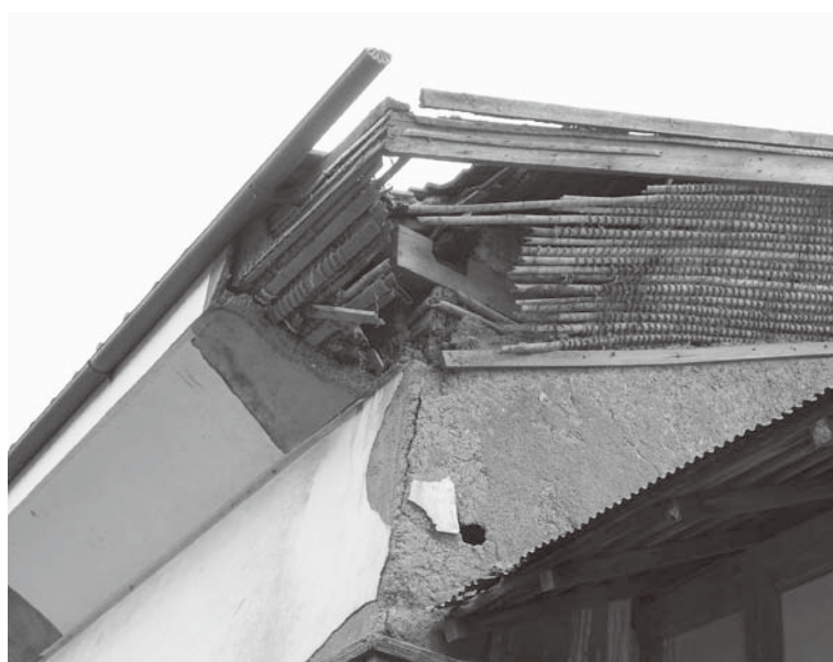
老朽化が進む倉庫（旧JA竹野支所）
