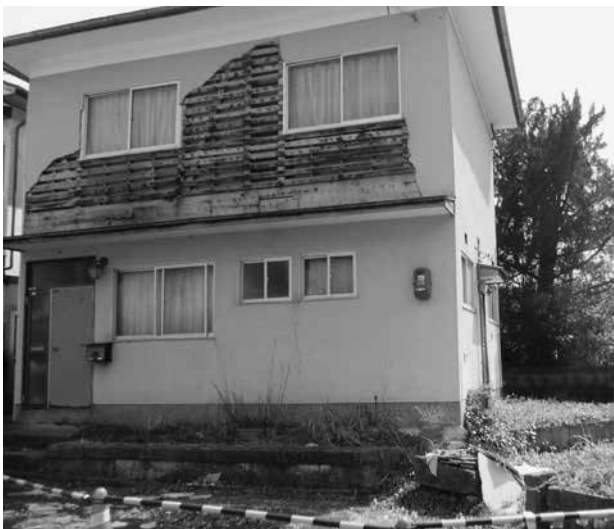
壁が落ちるなどしている空き家（グリーンハイツ地内）
