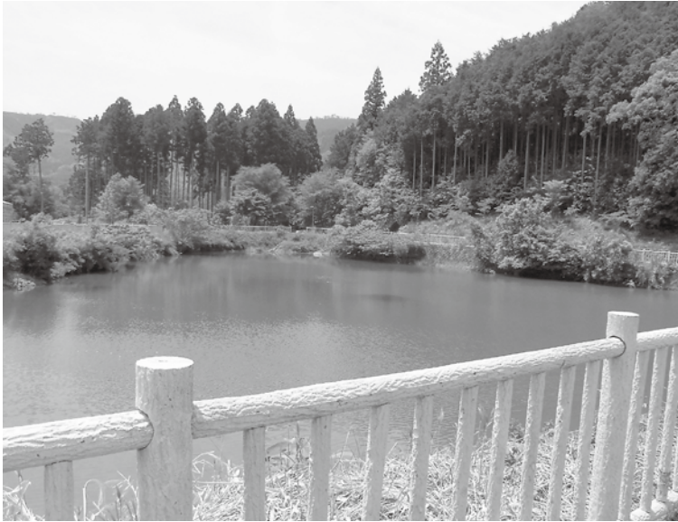
安全上改修が急がれる稲荷池（坂原地内）
