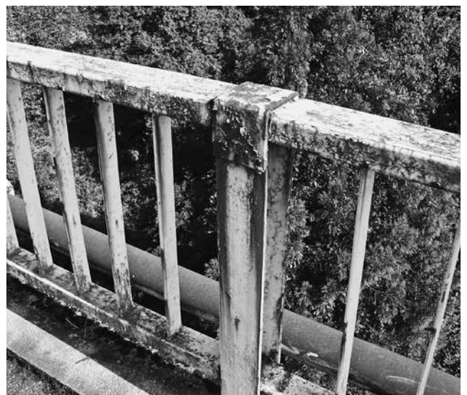
劣化が著しい上升谷橋(升谷地内)
