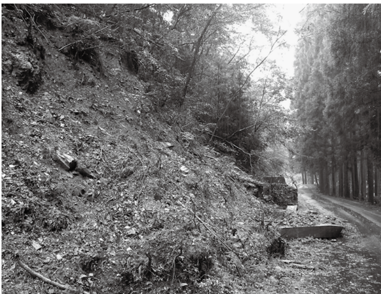
町道弓谷線崩落現場(鎌谷中地内)
