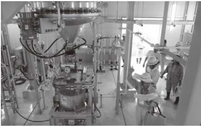
完成した粉末活性炭貯蔵室内(畑川浄水場)
