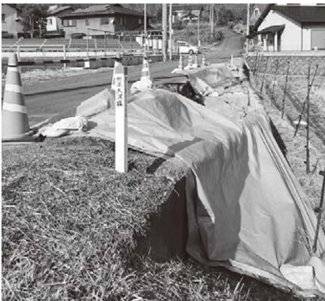
台風により崩れた路肩(中台地内)
