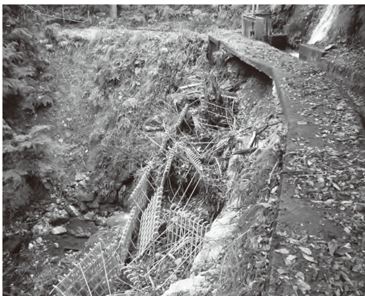
深刻な被害を受けた子来井根用水路(下乙見地内)
