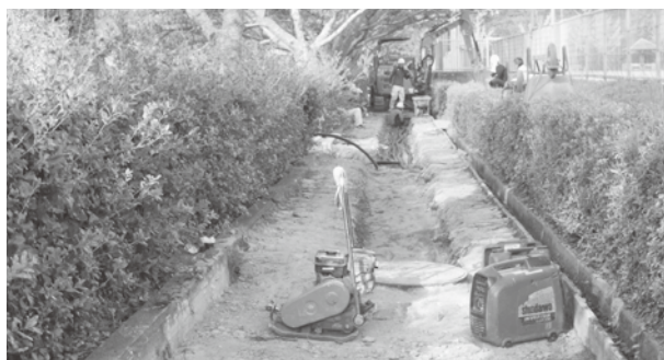
LED投光器照明柱の設置箇所
