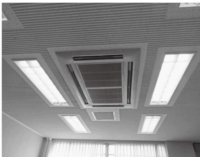
故障中のエアコン(和知中学校校長室)
