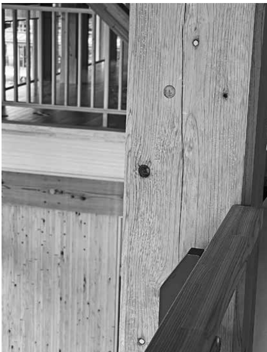
散見される柱のひび割れ(8月17日撮影)
