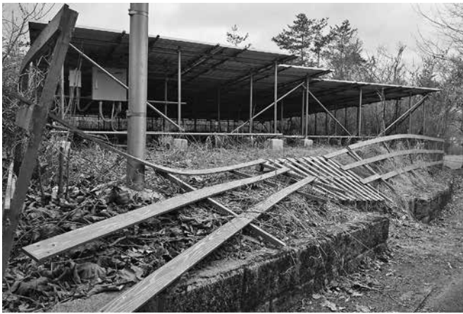
倒壊した太陽光発電施設を囲む柵(みのりが丘地内)
