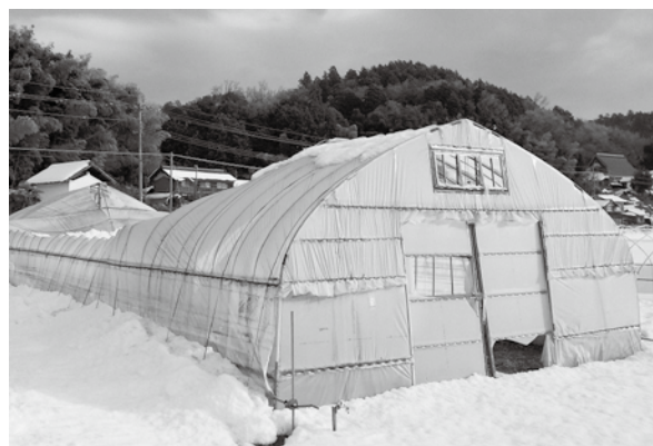
倒壊パイプハウス(橋爪地内)
