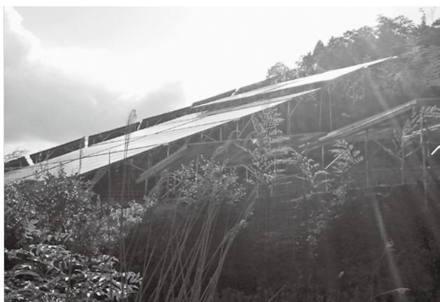
大規模太陽光発電施設（井尻地内）
