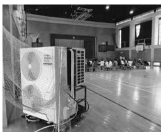
導入されたスポットエアコン
