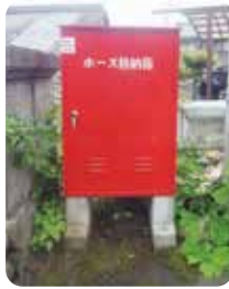
消火栓ボックス (下大久保区内)
