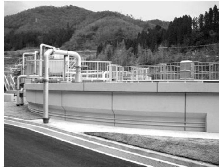
増設された下山浄化センター
