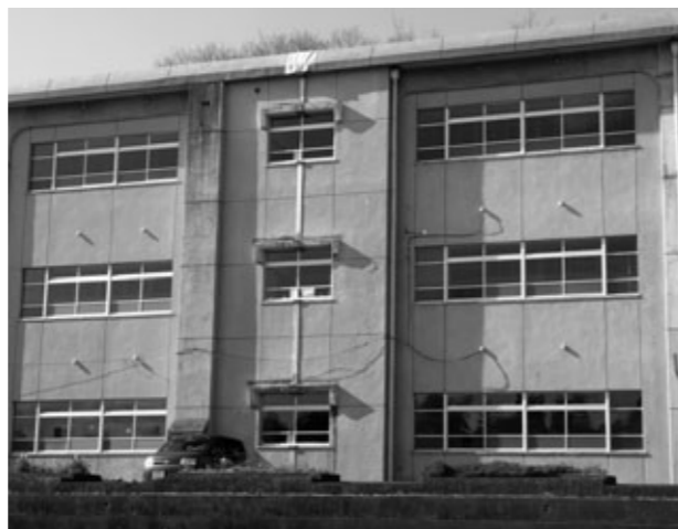
亀裂の確認を(桧山小学校)
