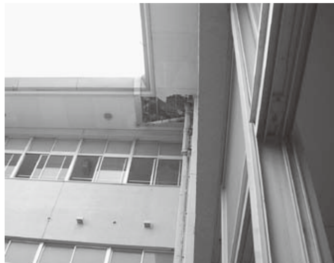
修繕が必要な教育施設（蒲生野中）
