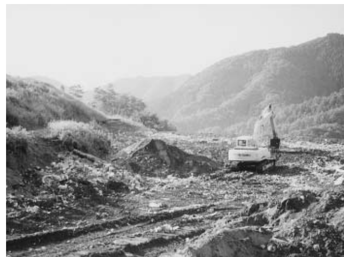
フェロシルト埋め立て現場(瑞穂環境保全センター)
