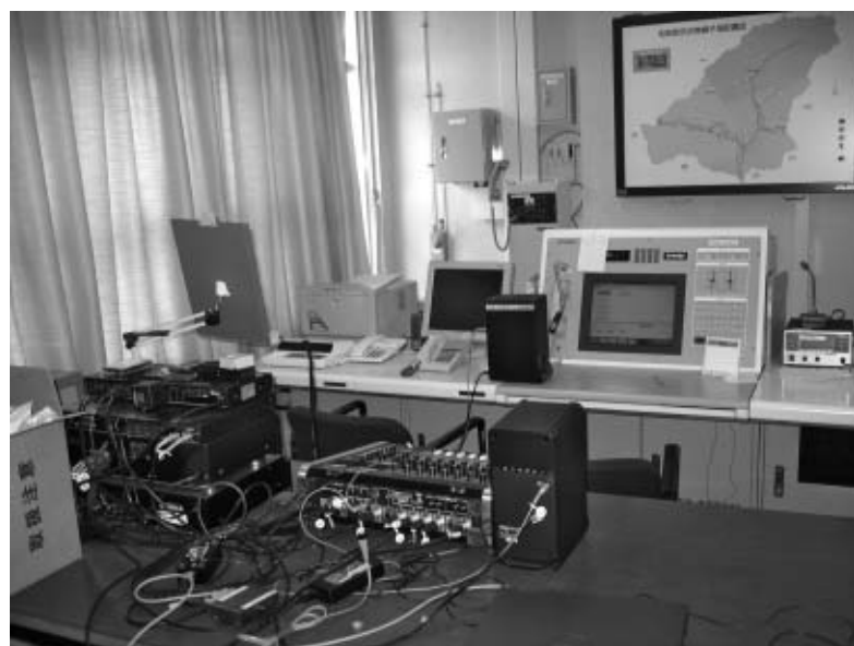
有効活用される防災無線設備（和知支所）
