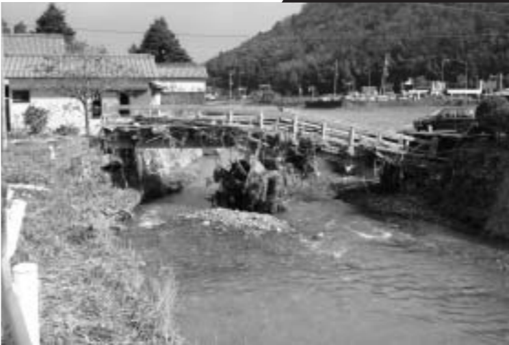
須知川のはん濫で橋が崩壊(須知)
