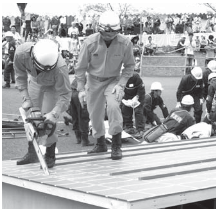
倒壊家屋内への侵入経路を確保するために屋根を電動ノコギリで切り開く消防署員
