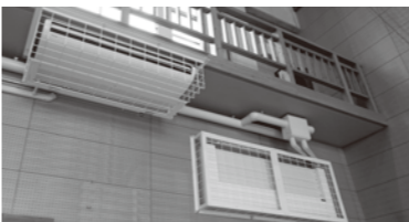
体育館に取り付けられたエアコン
