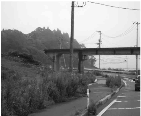
震災により切断されたままの南三陸鉄道 (南三陸町・丹波八坂太鼓保存会提供)
