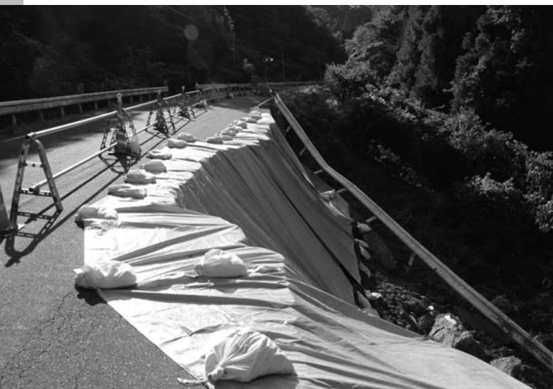
路肩が崩れた府道上野水原線。被害拡大を防ぐために、崩落箇所はシートで覆われた（質美）
