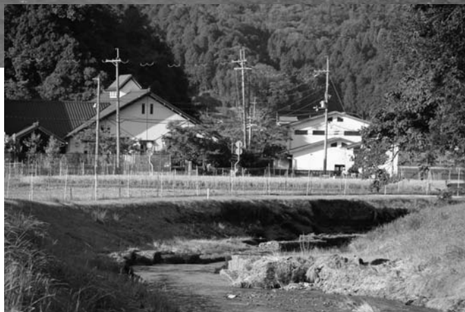
護岸が削られた竹野川（高岡）
